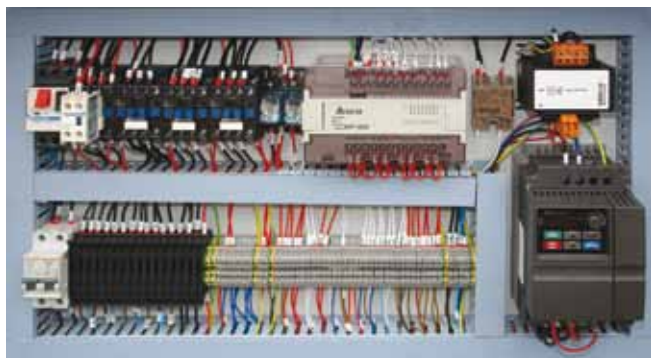
Электромонтажный шкаф выполнен в соответствии с ЕС-нормами.
